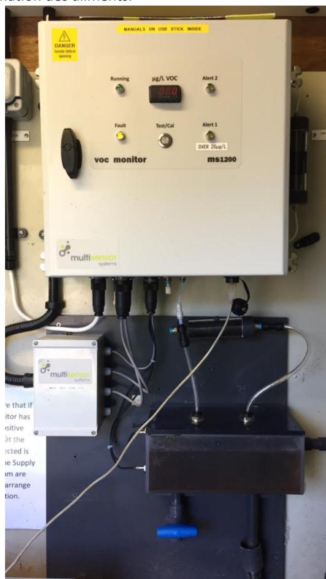
Figure 16- Une photo de l'unité installée dans la dépendance. L'unité contrôle une vanne d'écluse qui détourne le débit du réservoir en cas de contamination
