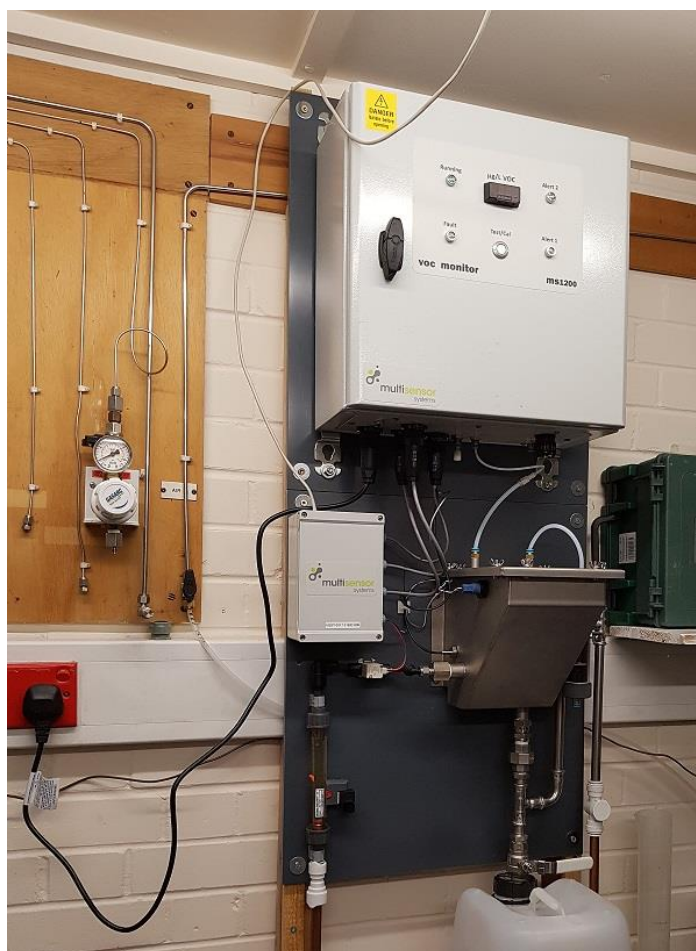
Figure 15 - Une photo de l'unité installée dans la dépendance. L'unité est connectée à un automate qui enregistre les données et, en cas d'accident, déclenche une alarme qui arrête les pompes d'admission.
