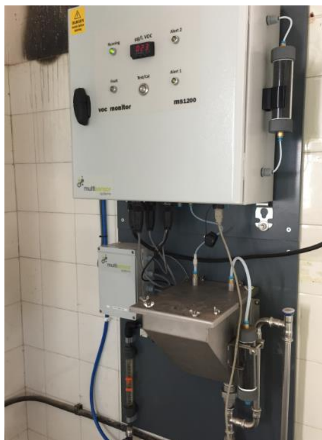
Figure 17 - Une photo de l'unité installée dans une dépendance à côté du forage.
